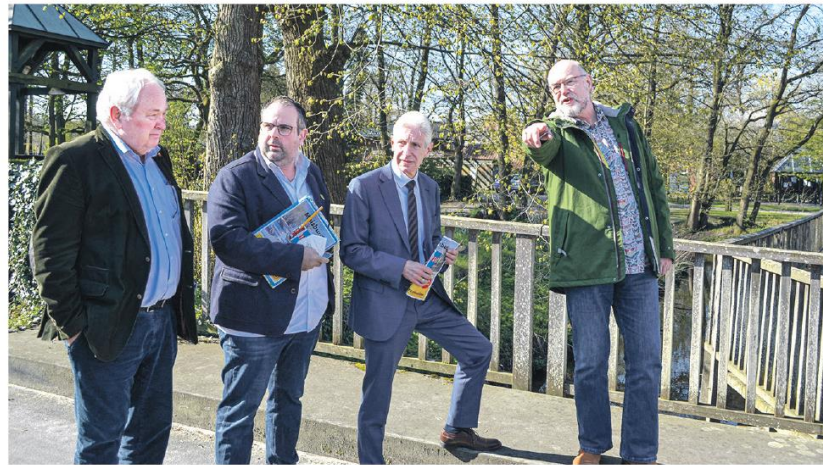
Moisburgs Bürgermeister Ronald Doll (re.) wies Landtagsabgeordneten Heiner Schönecke (v.li.), Jan Bauer, den Vorsitzenden des Kreisumweltausschusses und Landrat Rainer Rempe auf die abgesackte Fahrbahn der L141 hin. Fotos: bim
