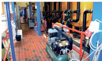
Blick in den Technikraum des Hollenstedter Freibades. Hier ist kein Platz für die neuen Schalt-schränke
