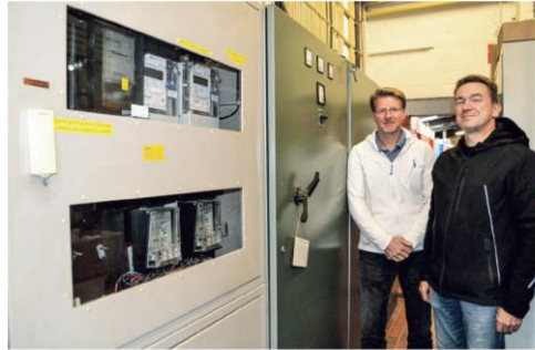
Hollenstedts Bauamtsleiter Daniel Heins (re.) und Badleiter Marco Wendt im Technikraum Foto: bim
