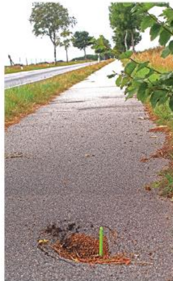
Bei der Sanierung des Radwegs an der K16 wurde ein Teilstück ausgelassen. Darüber berichtete das WOCHENBLATT 2018 Foto: mi
