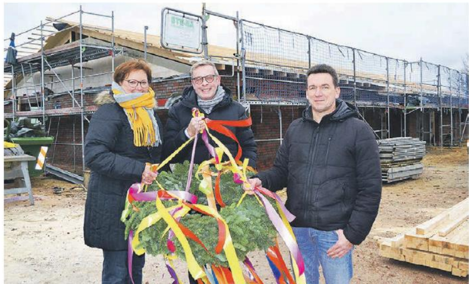
Mit dem Richtkranz vor der Kita-Erweiterung (v.li.): Bürgerserviceleiterin Kerstin Markuns, Samtgemeinde-Bürgermeister Heiner Albers und Bauamtsleiter Daniel Heins Fotos: bim
