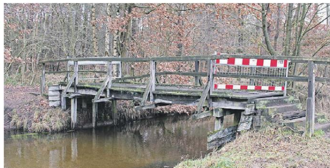
Gesperrt: Die Brücke über die Este ist so marode, dass sie neugebaut werden muss Foto: mi
