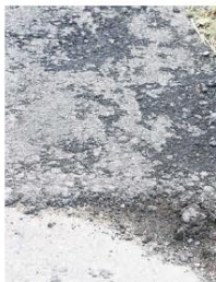
Neu und schon kaputt: Hier löst sich bereits der Asphalt
