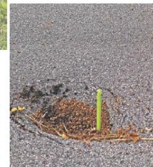
Dieses tiefe Schlagloch wurde nicht ausgebessert
