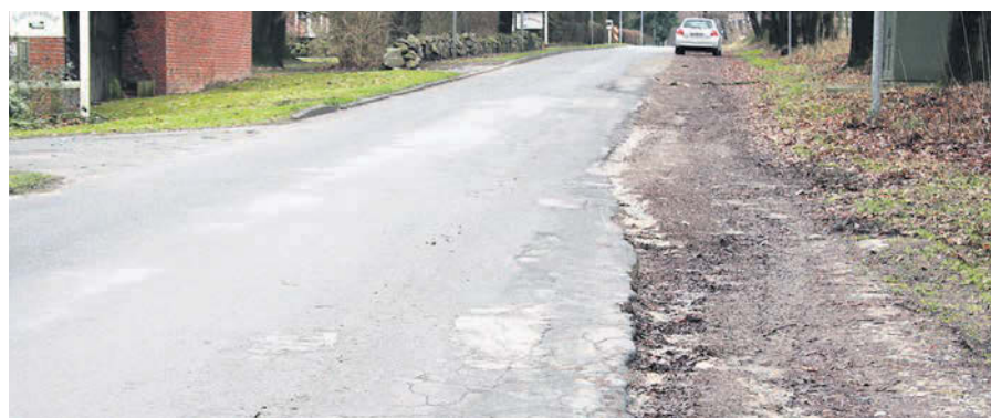
Für Fußgänger ein Hindernis: die zerstörten Seitenränder im Dangerser Weg
